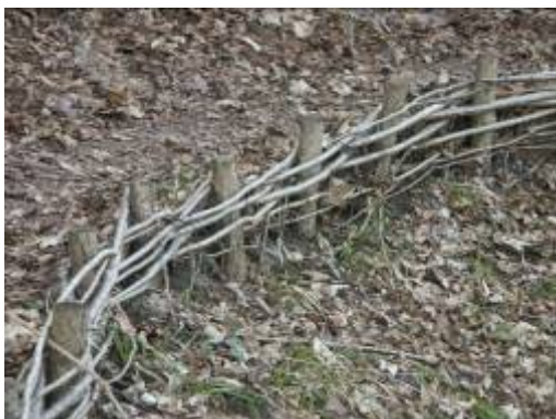
46. attēls. Nostiprināta Gaujas senlejas nogāze Kalnu velotūrisma maršrutā Siguldā, Gaujas nacionālajā parkā
