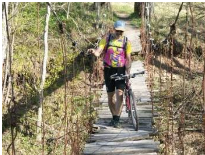
52. attēls. Trosu tilts (avārijas stāvoklī) pāri Ogres upei
