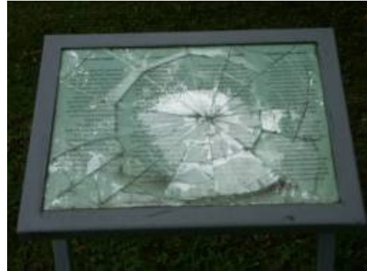
54. attēls. Tūrisma informācijas plāksne ar sadauzītu stikla pārsegumu (nepiemērota materiāla pārsegums)
